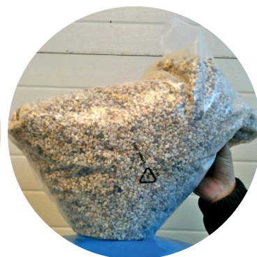
4 : Charger le silice puis le sable puis les médias filtrants du + lourd au + léger
